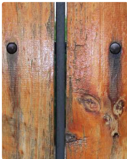
LÁGRIMAS DEL DIABLO: MANCHAS DE TANATO DE FIERRO PROVOCADAS POR LA REACCIÓN QUÍMICA, ENTRE EL ÁCIDO TÁNICO DE LA MADERA Y EL FIERRO.
