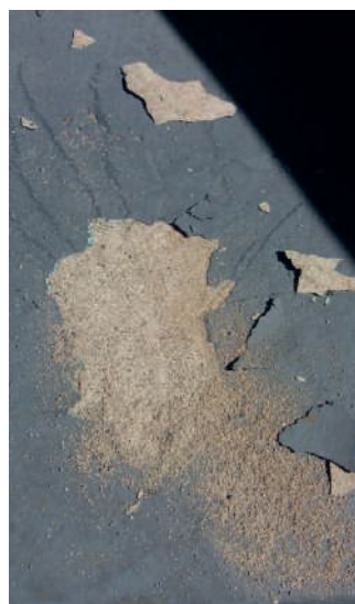
SUPERFICIE ARENOSA DEBIDO AL DAÑO DEL ÁCIDO MURIÁTICO
