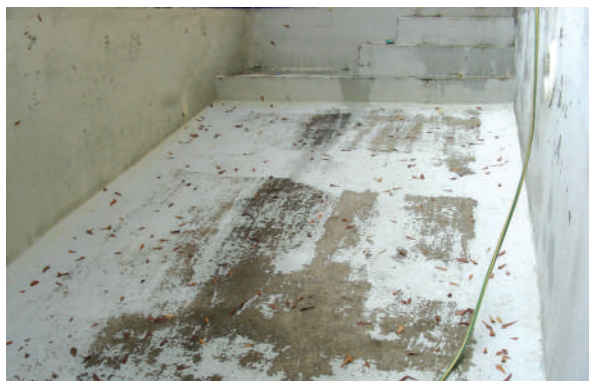
ESTUCO DAÑADO POR ÁCIDO MURIÁTICO.
