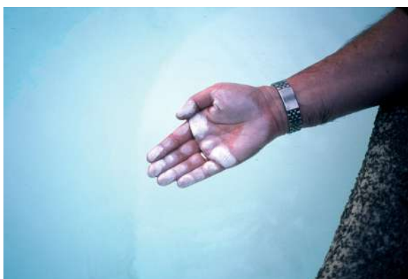
TIZAMIENTO QUÍMICO. TÉRMINO DE LA PINTURA EN LAS PISCINAS, POR VEJEZ NATURAL DEBIDO A LA ACCIÓN PROVOCADA POR DEL CLORO.
