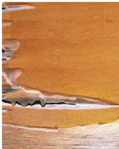
BARNIZ DAÑADO POR ACCIÓN DEL TIEMPO.
