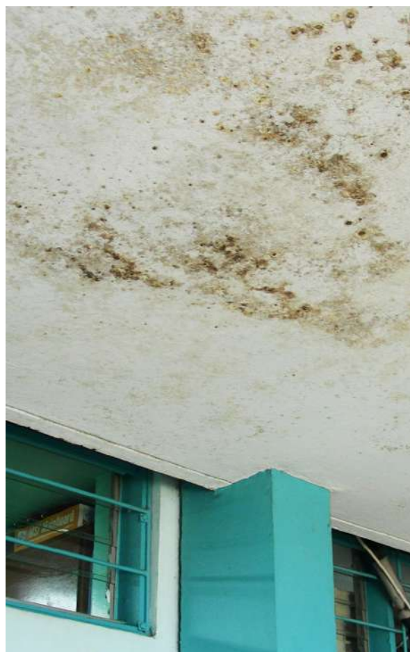
HONGOS EN CIELOS, POR ALTA HUMEDAD, POCA LUMINOSIDAD, Y FALTA DE HIGIENE.
