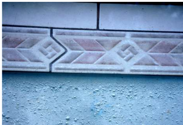
AMPOLLAS PRODUCIDAS POR PERMEABILIDAD DE LA ESTRUCTURA DE LA PISCINA, RESPECTO DEL AGUA DEL JARDÍN QUE LA RODEA.
