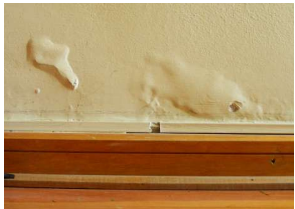
DAÑOS POR HUMEDAD DE UN MURO ALEDAÑO A UN BAÑO.
