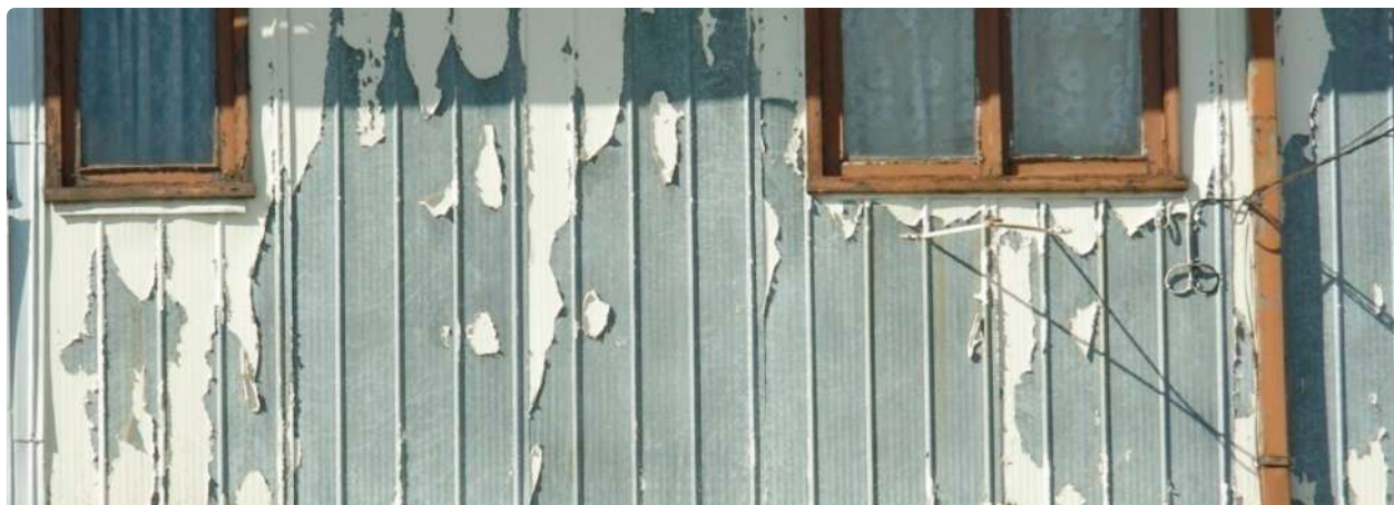
ÓLEO DESPRENDIDO POR INCOMPATIBILIDAD DE PRODUCTO Y SUSTRATOESMALTE AL AGUA CONSTRUCTOR.
