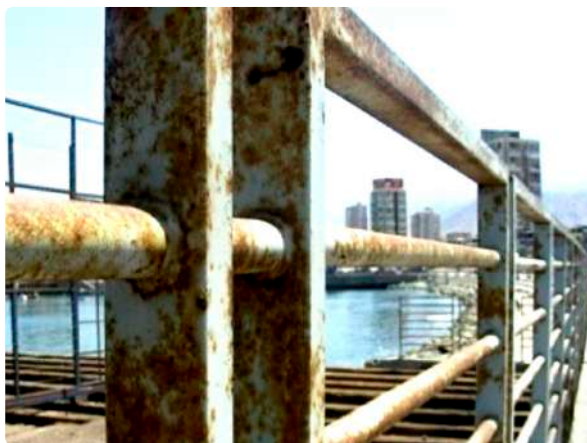
CORROSIÓN POR NIEBLA SALINA CERCANA AL MAR, ANTOFAGASTA.
