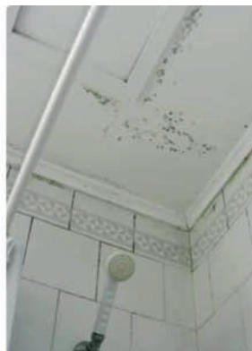
CIELO NO VENTILADO DAÑADO POR HONGOS.
