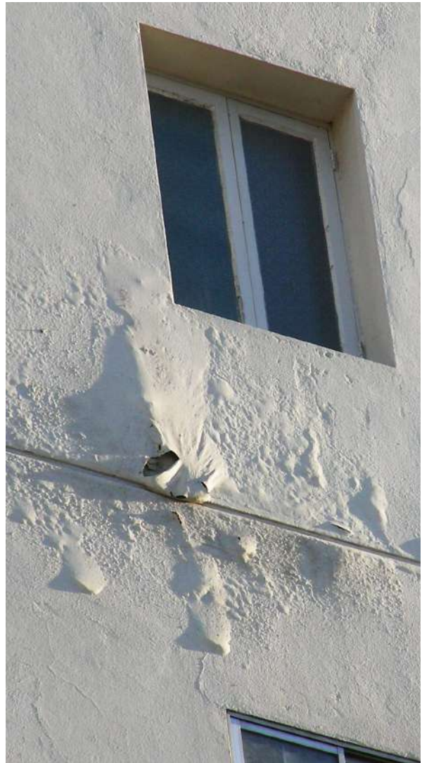
DAÑOS POR HUMEDAD EN LA PARED, POR FUGA DE AGUA.
