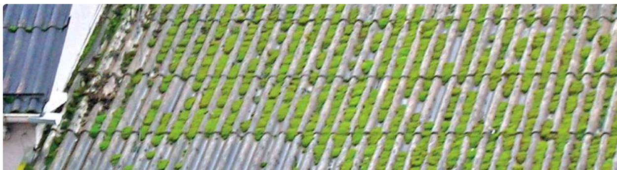
TECHO DAÑADO POR VEJEZ, NO PINTABLE.
