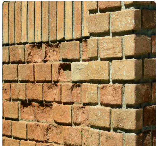
LADRILLOS SIN PROTECCIÓN DAÑADOS POR LLUVIA Y RIEGO.
