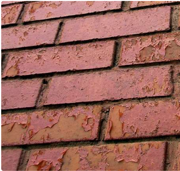
BARNIZ MARINO DESPRENDIDO POR SAPONIFICACIÓN.
